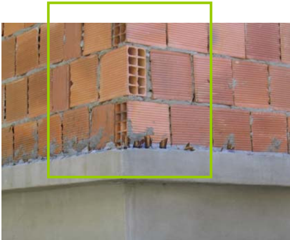
42. Detalhe de Edificação Inacabada. Fonte: Eliene Tozetto, 2004.
