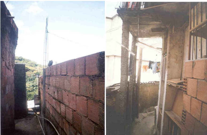
36 e 37. Residências inacabadas. Fonte: Eliene Tozetto, 2000.
